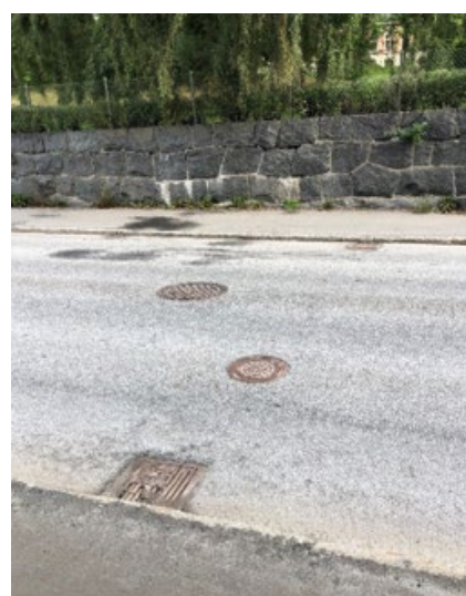
Dagvattenbrunnar längs Östra strandgatan där vatten samlas enligt skyfallskartering
